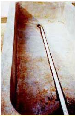
Pila con tubo PVC perforado
